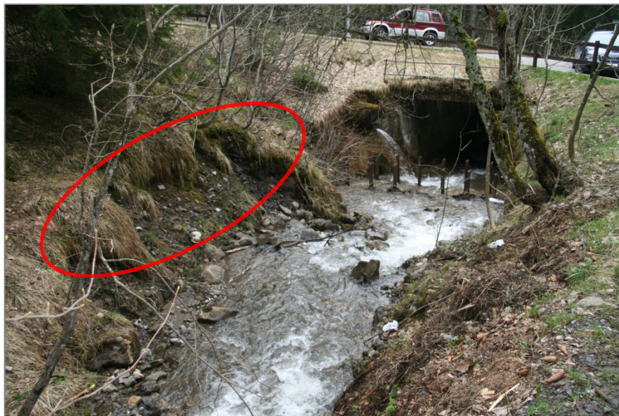
Fig. 1. Etat initial : alternance de glissements et de niches d'érosion en rive gauche.
