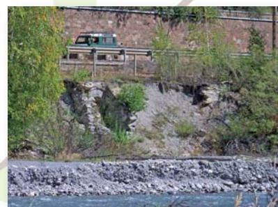
Erosion et enjeux d'infrastructure (route, voie ferrée et réseau électrique)
